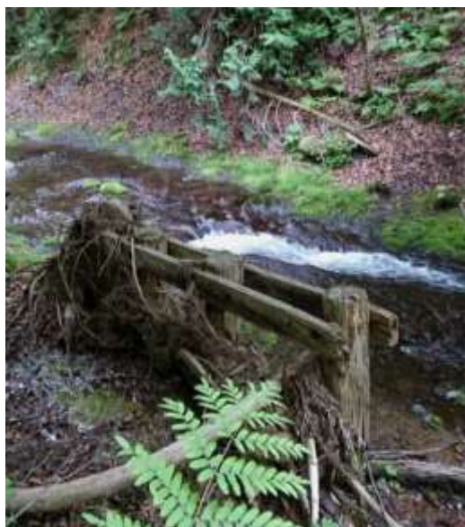
流木が絡んでいるヒバ材の橋脚 対岸には柱の穴がまだ残っている
